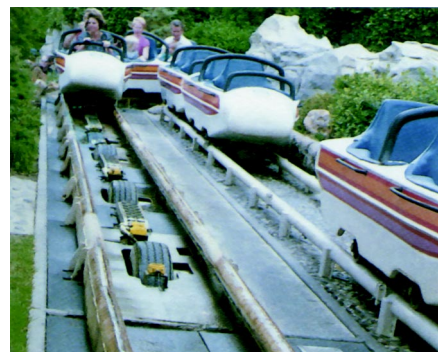
Оборудование аттракциона: контроль прихода тележки на позицию
