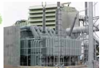
Генераторный повышающий трансформатор 500кВ/390МВА Энергетическая Компания штата Джорджия, США.
