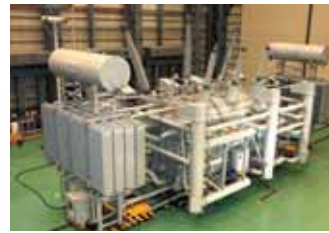
Трансформатор 512,5кВ/ 500МВА Гидроэнергетический комплекс в Британской Колумбии, Канада.
