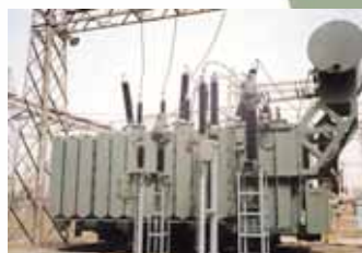
Трансформатор 220кВ/125МВА Египетская Электрическая Компания.
