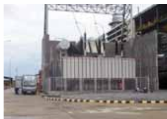
Генераторный повышающий трансформатор 235кВ/ 500МВА Электростанция в Таиланде.
