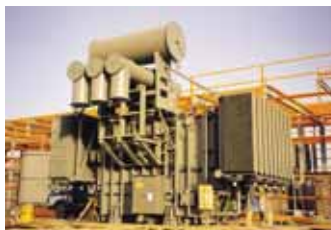
Трансформатор 132кВ/ 230МВА Проект Al-Qaseem в Саудовской Аравии
